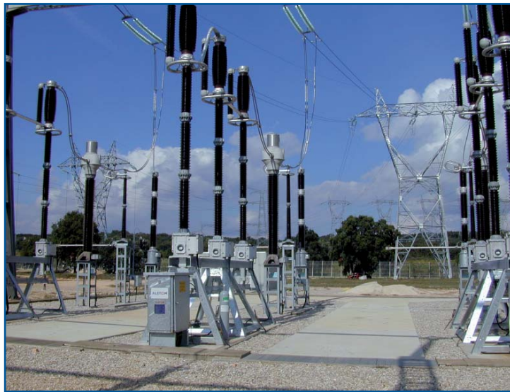
Exemple de cellule-ligne 400 000 volts
