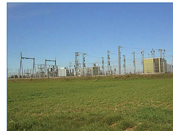
Exemple de sous-station ferroviaire
