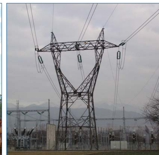
Exemple de pylône L1
